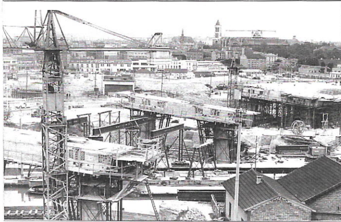
PHOTO de PIERRE DOUZENZEL - AVRIL 1966 Le territoire situé au sud-est du Carrefour de la Porte de Paris, pendant les travaux de construction du viaduc de l'autoroute. Vue prise du sud de l'écluse
